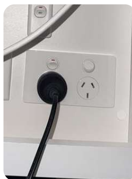
240-volt set up
